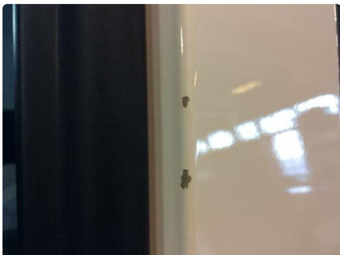
1.2 Lakk sår v fordør og v skyvedør
