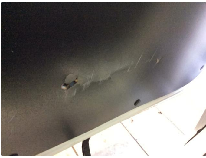
2.1 Skade på sidedeksel h skyvedør. En del riper i lakkvarerom og på deksler
